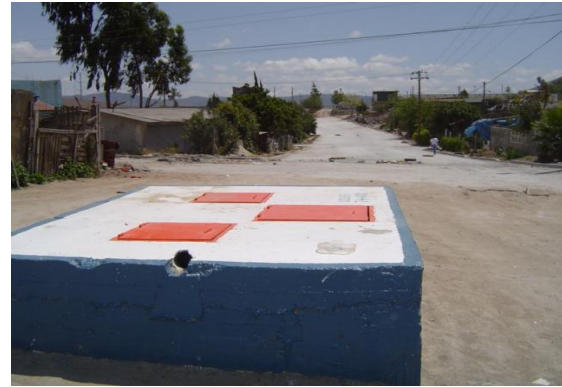
VAYEA del acueducto que pasa por el cruce de las calles Yucatán y Guadalajara elevación 216 msnm, Col. Pípila, Km7 +400
