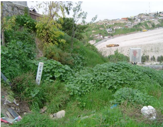
Tramo del acueducto donde se desacopló la tubería en la calle Melchor Ocampo, Col. Los Maestros.
