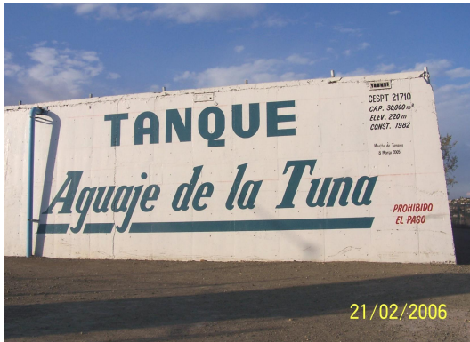
Inicia el acueducto en el Tanque Aguaje de la Tuna con capacidad de 30,000m 3
