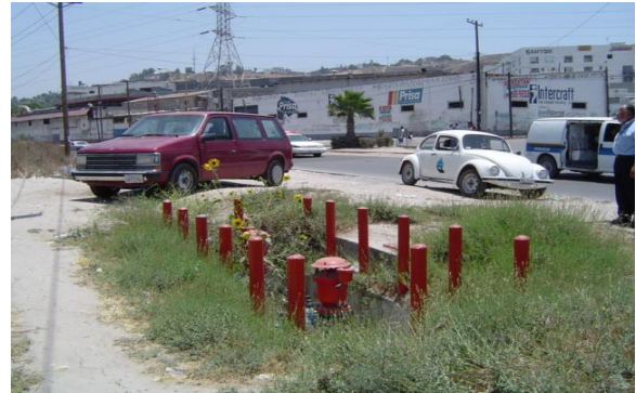
VAYEA del acueducto que pasa por cruceo del Blvd. Insurgentes, de la Col. Lomas de la Presa, KM 9+428.29
