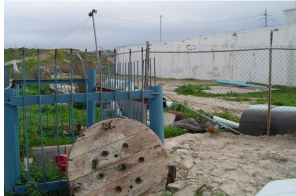
Derivación de 48" de diámetro del Tanque Aguaje de la Tuna hacia la Planta de Bombeo Obrera.
