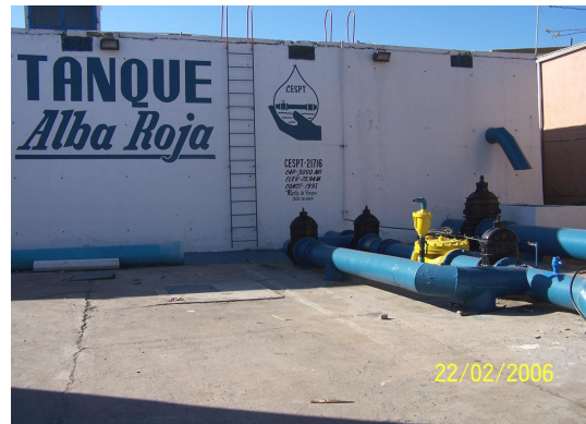
Llegada del acueducto al Tanque Alba Roja, elevación 74 msnm, capacidad 5,000m 3 .
