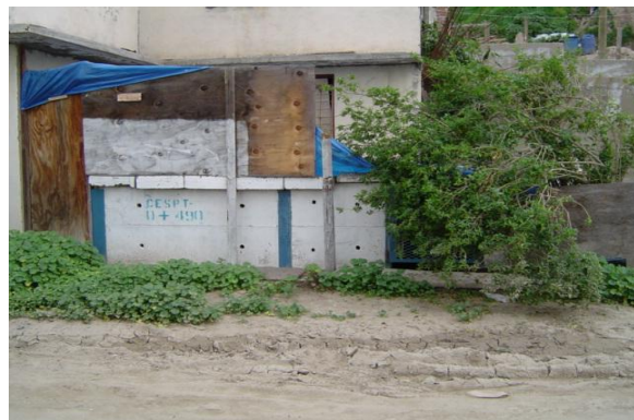
Afectación de VAYEA del acueducto dentro del lote No. 1 de la col. Internacional.
